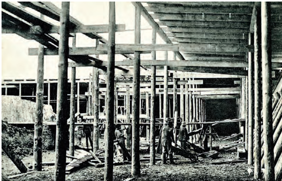
Nr 2.209. Budowa zbiorników ziemnych o pojemności 1500 cystem na ropę naftową według projektu Izzydora Schulza między Boryslawiem a Modryczami. Pocztówka z 1909 r. z wydawnictwa J. Piłpla w Drohobyczu
